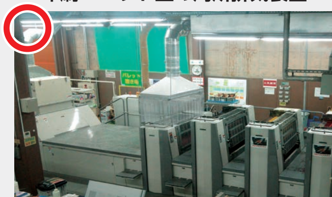
印刷ユニット上の局所排気装置
